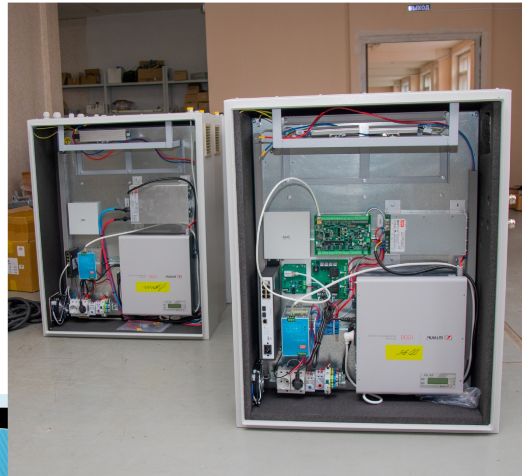
Комплекты электропитания комплекса
